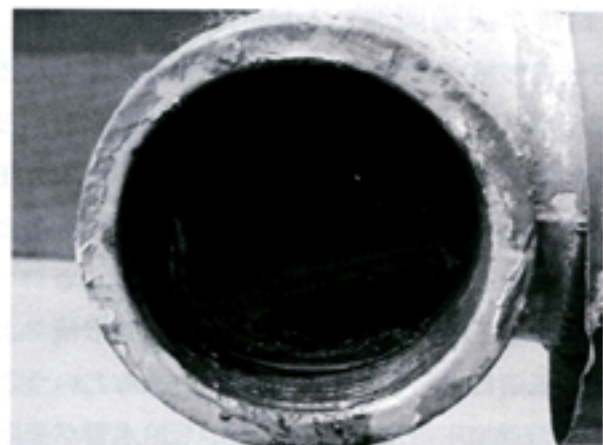
写真1 管端部ごとに発生した給水本管の錆こぶ
