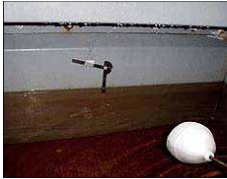
消火栓補助水槽（建物屋上） の漏水を示す状況 水位測定状況
