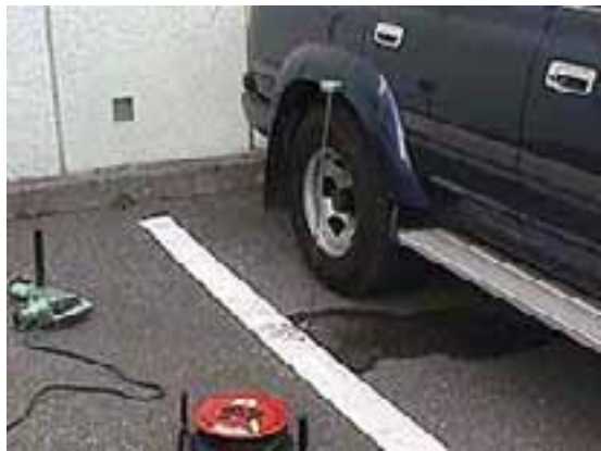
同建物駐車場からも発見。漏水量毎分8リットルと推定。
