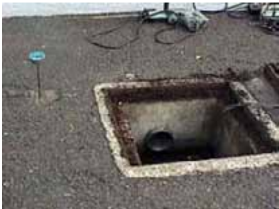
排水樹に流れ込んでおり傍のアスファルトに穴を開けると 漏水が吹き出ってきます。
